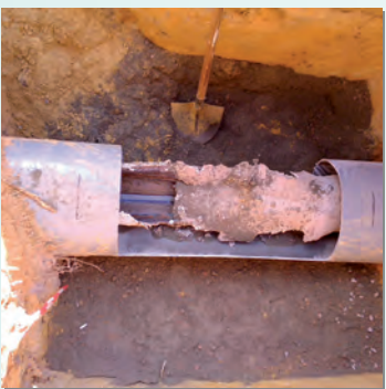
Canalisation dégradée par réaction chimique
